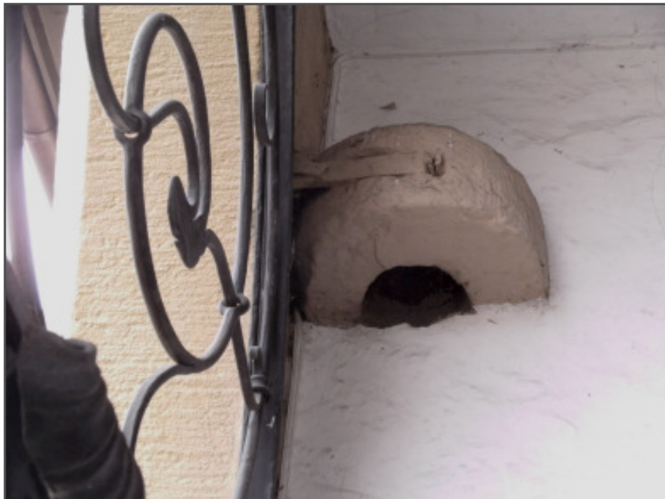
Der selbe Lochstein der linken Seite von innen gesehen Die ehemals vorhandenen unteren Lochsteine wurden entfernt. Es konnte nicht festgestellt werden, ob der eiserne Bügel den Lochstein oder das schmiedeeiserne Gitter hält.
