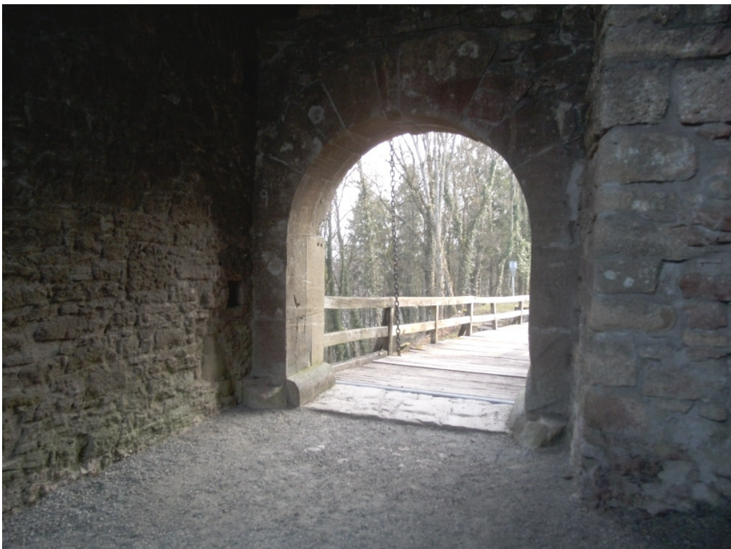
Das Tor von innen. Man erkennt einen der Radabweiser sowie unten in den Ecken die beschädigten Türscharniere
