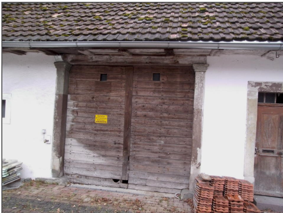
Das Haus ist seit langem sanierungsbedürftig. Was dann mit dem Tor geschehen wird, ist völlig ungewiss.
