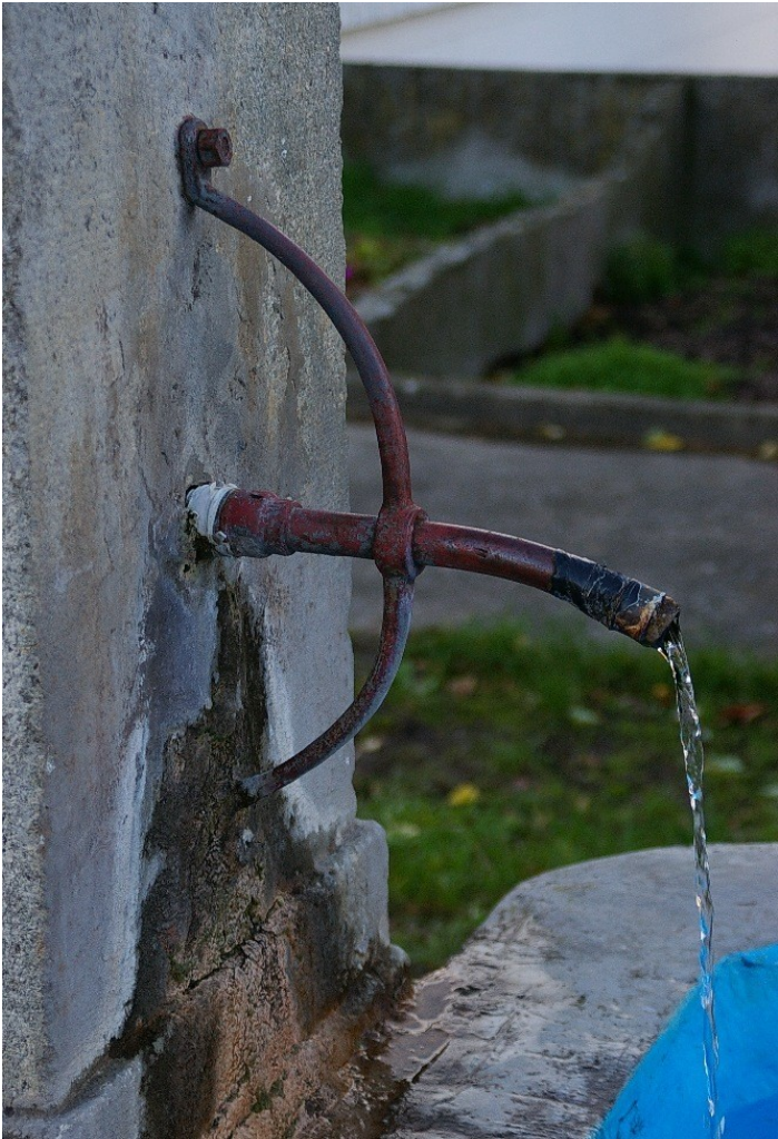
Der Brunnen zeigt deutliche Altersspuren an den Zulaufrohren und hätte auch generell eine Restauration nötig
