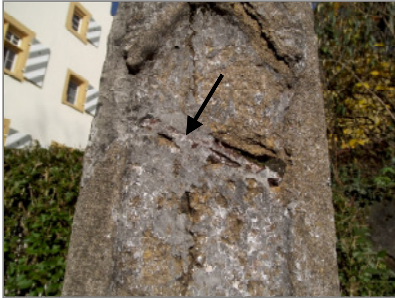
Senkrechter Riss und alte Steinklammer
