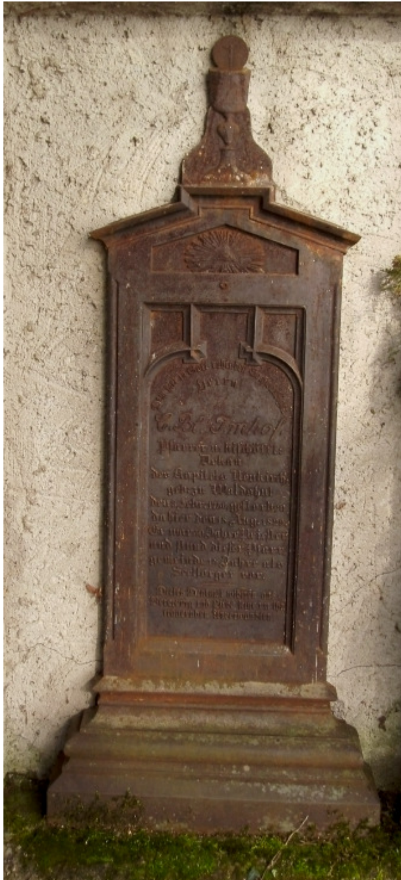
Das Bild zeigt den starken Rostbefall des Epitaphs
