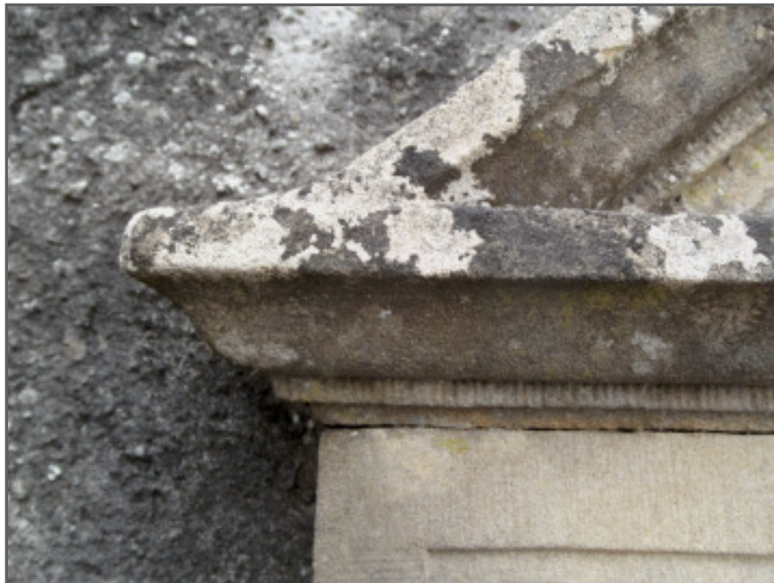
Fuge zwischen Grabplatte und aufgesetztem Giebdreieck. Das Kraggesims ist ebenfalls sehr aufwändig gestaltet.
