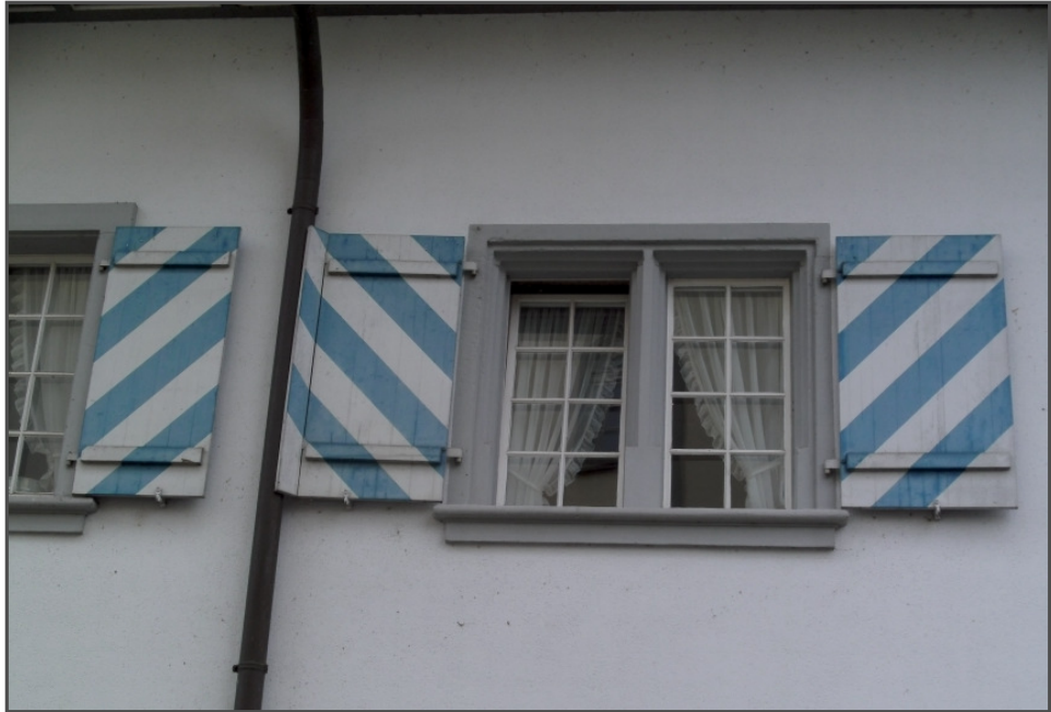
Doppelfenster, neu und stilecht wiederhergestellt. Das Haus hat von der Kirchstraße her ein Eingangsportal mit Rundbogen, darüber befindet sich das abgebildete Fenster.
